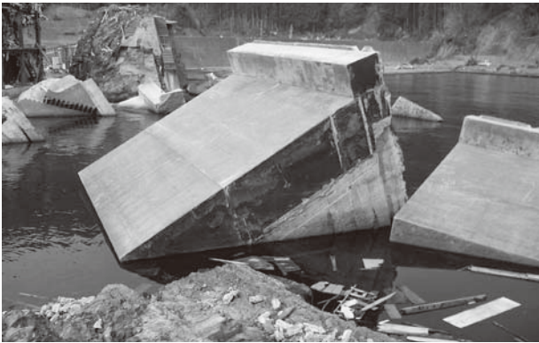
▲釜石市で防潮堤が倒壊している状態
